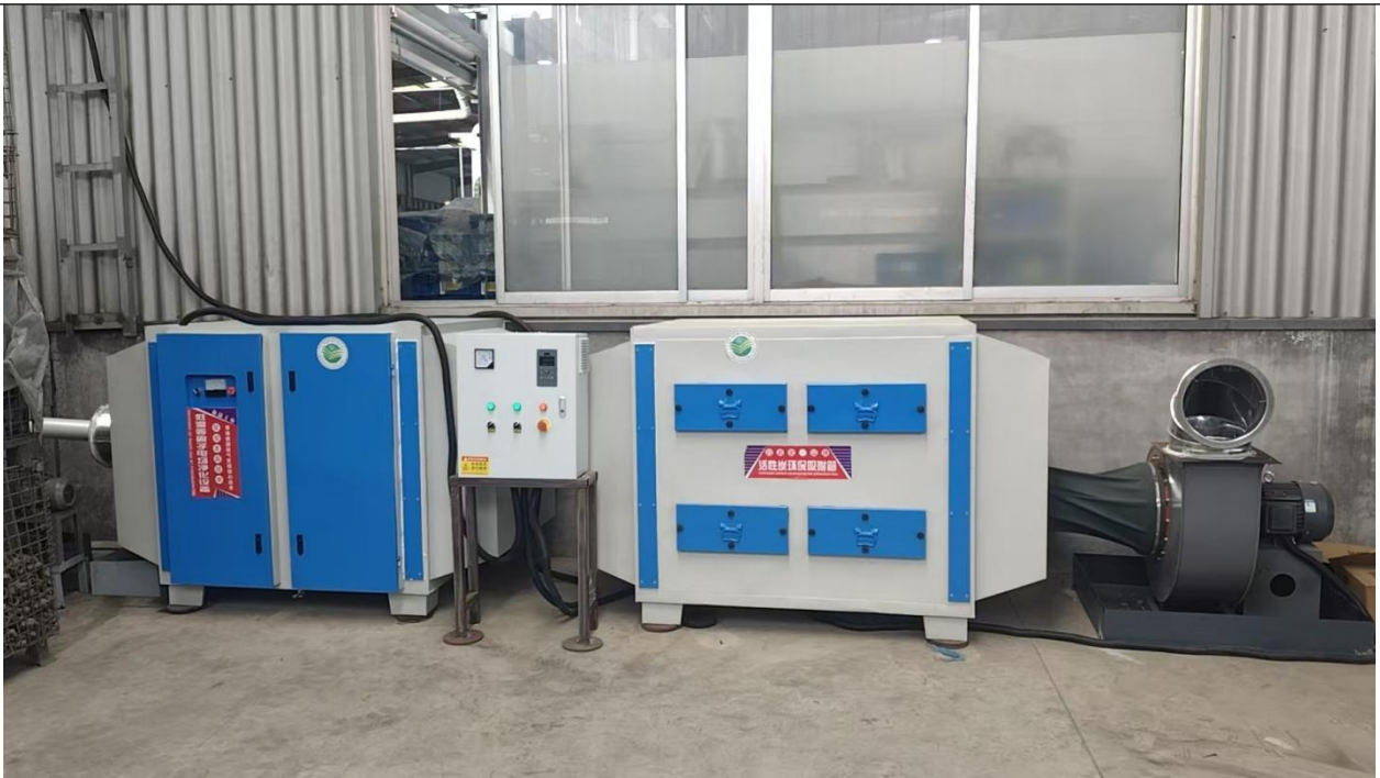
南厂区油烟净化器+活性炭吸附装置
