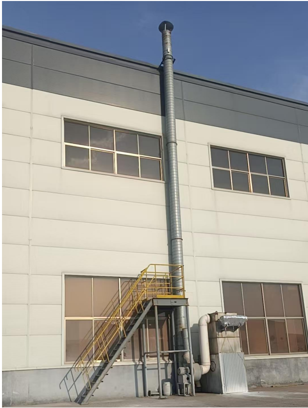
1#布袋除尘器+15米排气筒 DA005 排放
