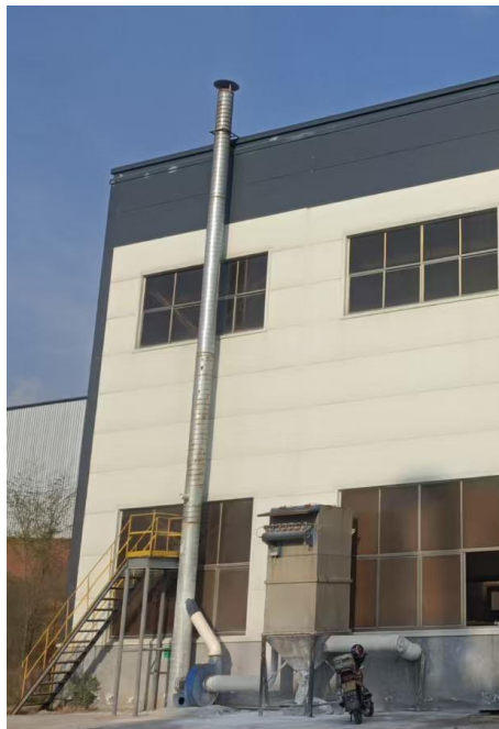
3#布袋除尘器 DA007 排放
