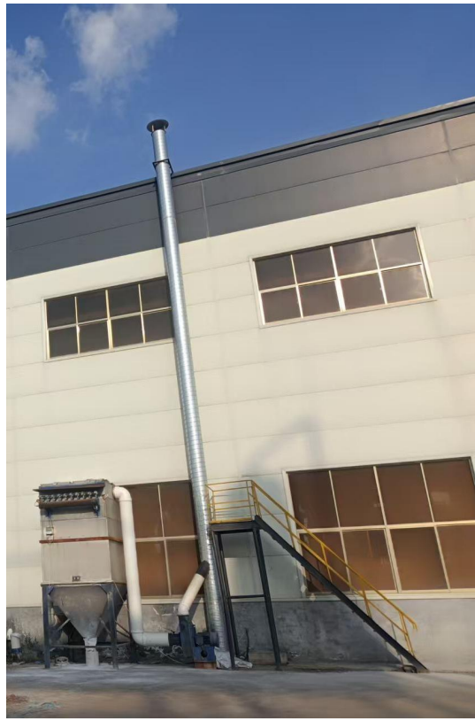
2#布袋除尘器+DA006 排放
