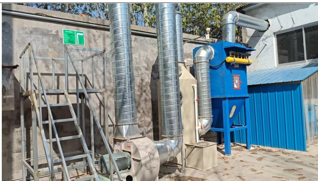
布袋除尘+水喷淋+15m 排气筒 DA006
