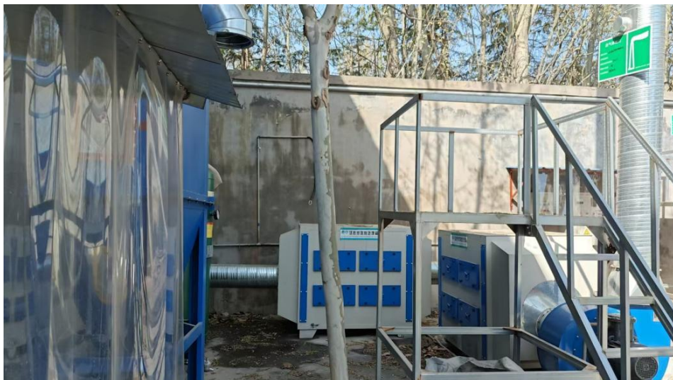
活性炭吸附装置+15m 排气筒 DA005
