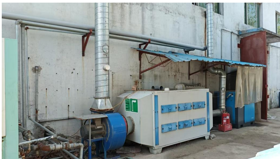
活性炭吸附装置+15m 排气筒 DA004
