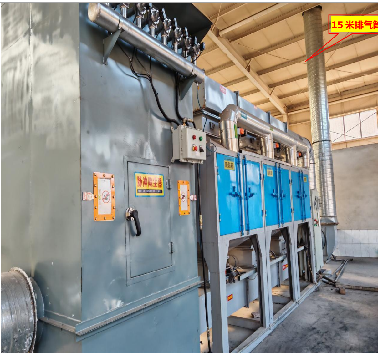
布袋除尘器+活性炭吸附脱附催化燃烧+15 米排气筒
