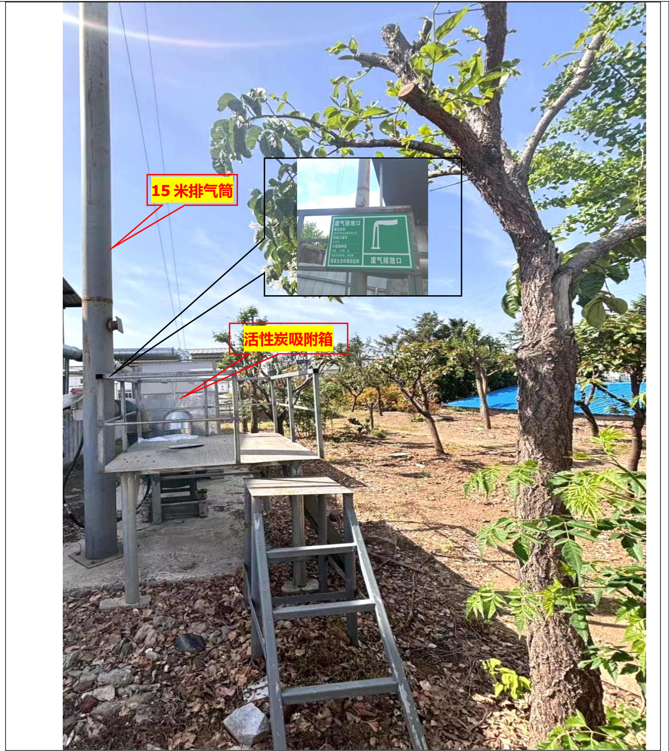
活性炭吸附装置+15 米排气筒
