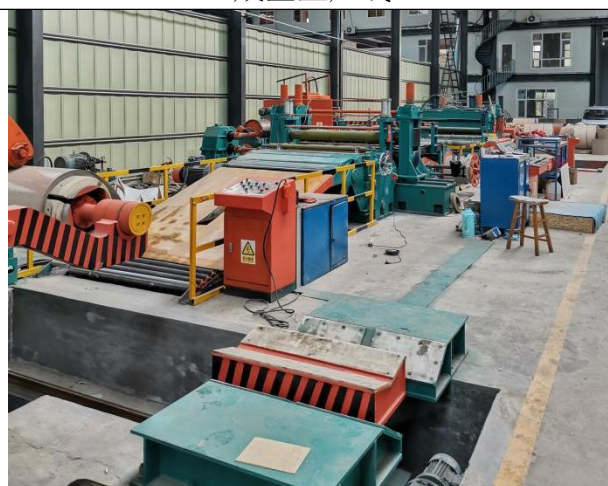
建筑轻钢骨架生产线
