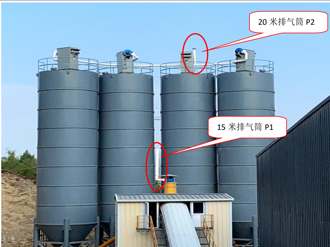
搅拌机滤芯除尘器 15 米排气筒 P1
