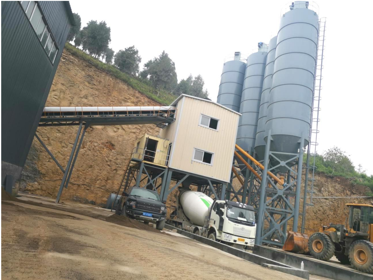
商品混凝土生产设备
